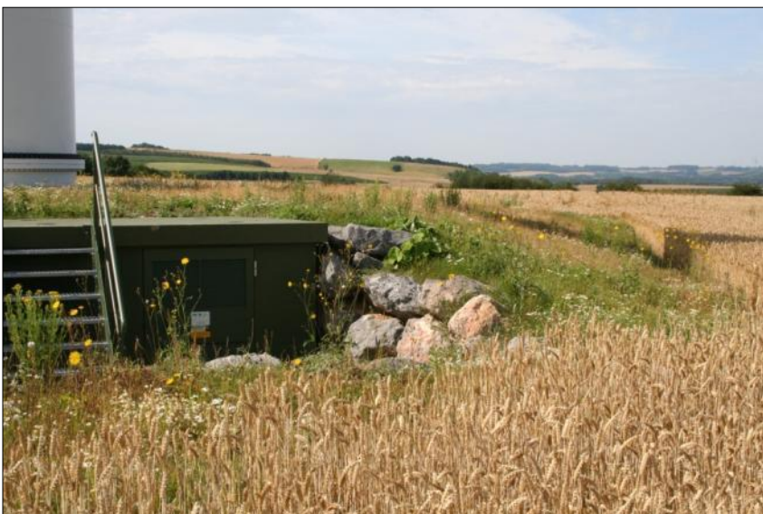
Photo 6 : Poste électrique au pied du mât (Source : Maia Eolis).
